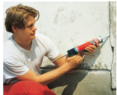
Putzrisse können mit PCI Adaptol plasto-elastisch geschlossen werden.
